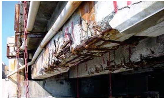
図1 塩害によるコンクリート構造物の劣化
