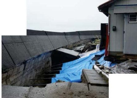
写真1 高潮により空洞化した防潮堤背面
