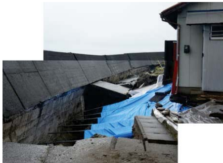
写真1 高潮により空洞化した防潮堤背面
