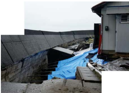
写真1 高潮により空洞化した防潮堤背面
