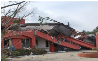
図1 東日本大震災の津波で全壊した宮城県の高齢者施設
