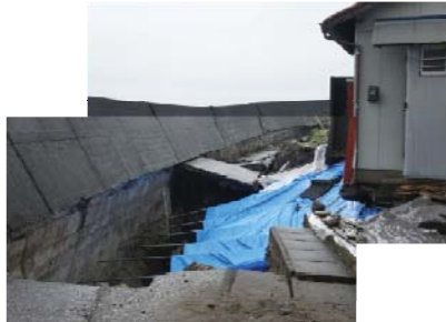
写真1 高潮により空洞化した防潮堤背面
