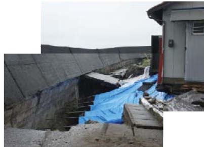
写真1 高潮により空洞化した防潮堤背面
